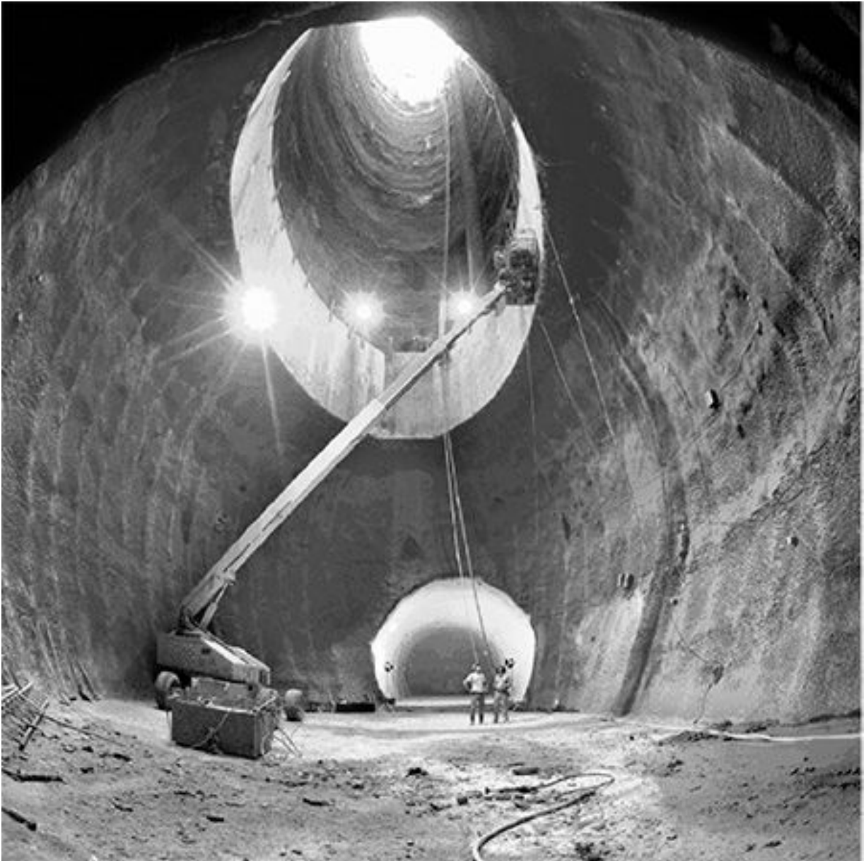
20. Obras do túnel do Superconducting Super Collider, SSC, projeto abandonado pelo governo americano em 1993.
