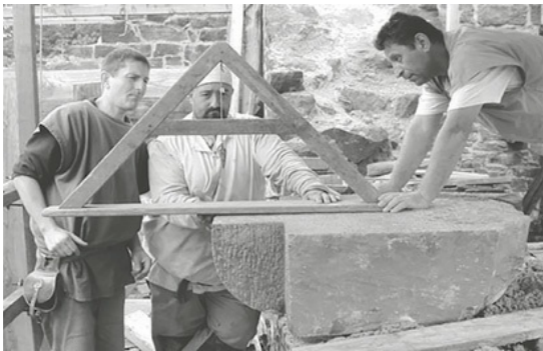
Os trabalhadores examinam uma pedra para se certificar de que ela está nivelada no canteiro de obras de Guédelon. Foto: cortesia de Guédelon, ©Guédelon.
